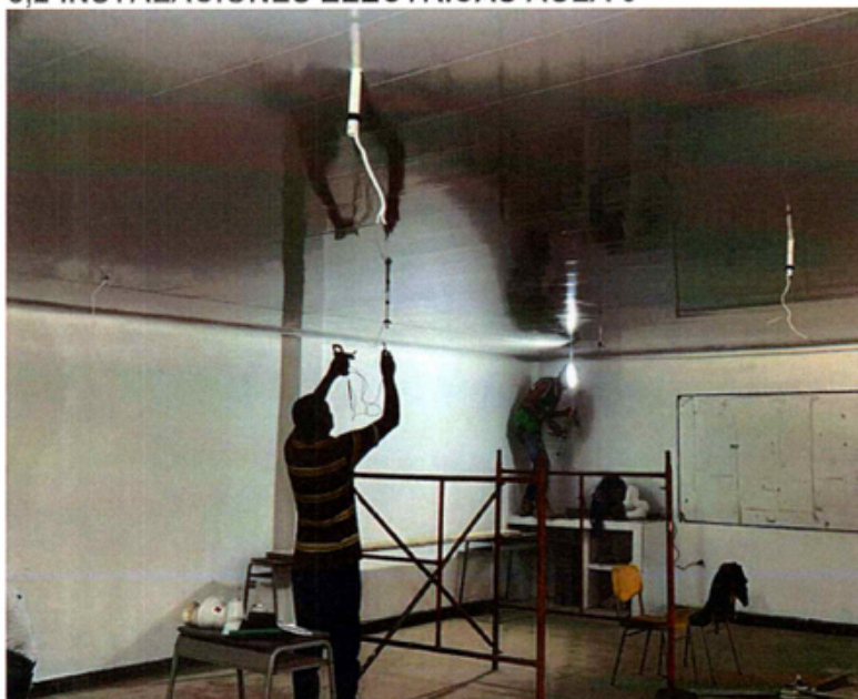
5,2 INSTALACIONES ELECTRICAS AULA 5
